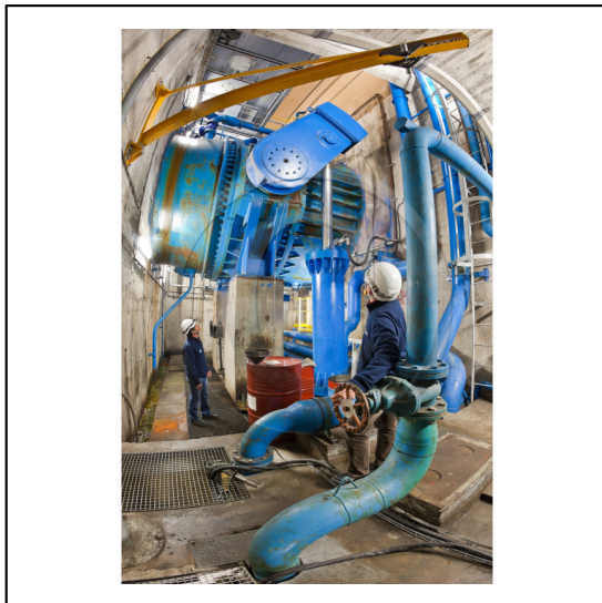
Hautes-Alpes, 05, Lac de Serre-Ponçon, Rousset, Barrage de Serre-Ponçon, usine hydroélectrique EDF, salle des vannes // Hautes-Alpes, 05, Lac de Serre-Ponçon, Rousset, Serre-Ponçon Dam, EDF hydroelectric plant, valves room
